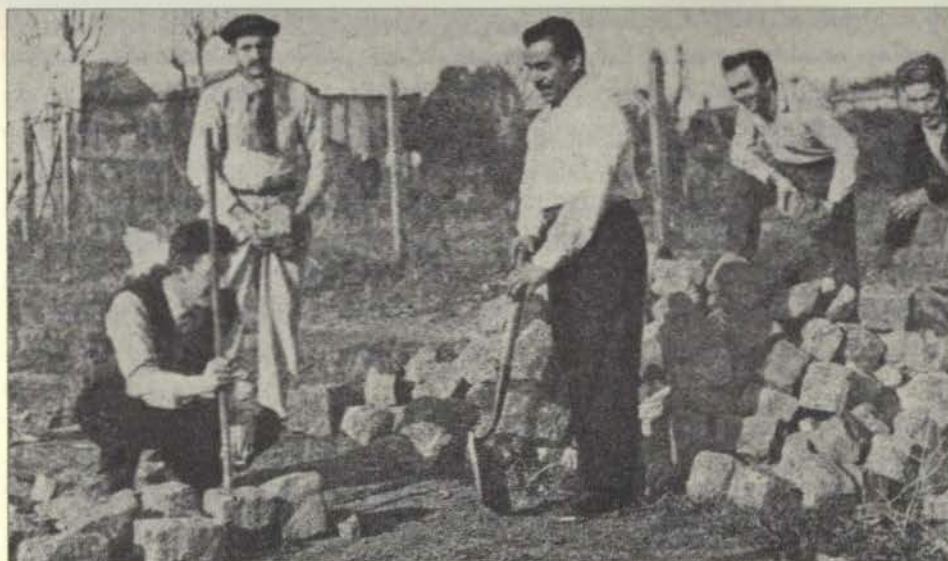
Vecinos trabajando en la construcción de pasos de piedra. Foto en Municipio de Morón, publicación «Al finalizar un mandato», 1952.
